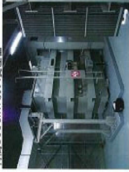
特高6000kVAガス変圧器
