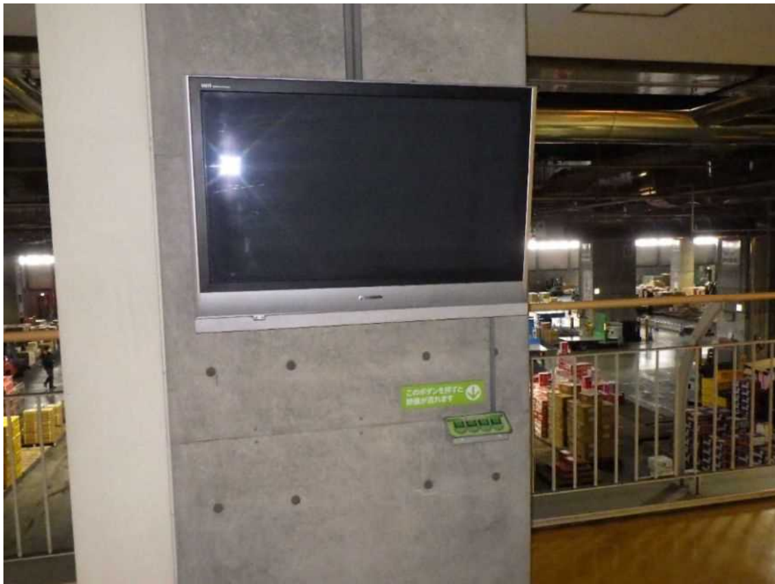
青果棟 2階見学者通路 モニター・操作ボタン（2箇所）
