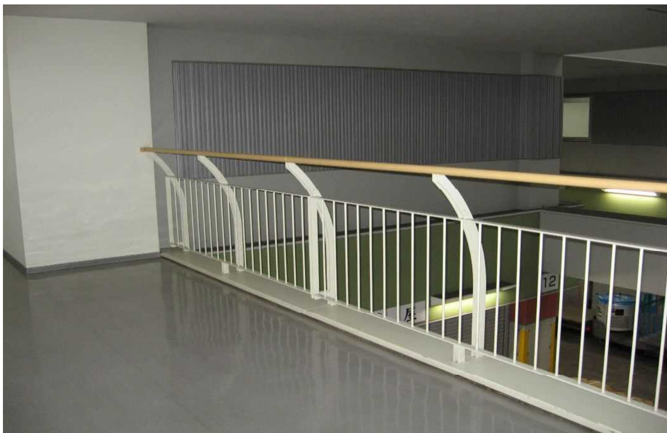
青果棟 2階 仲卸事務所通路側手すり
