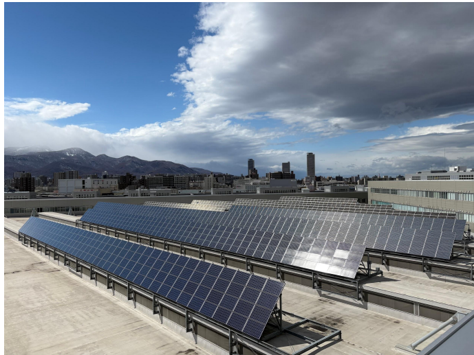
【写真：太陽光発電システム（センターヤード屋上）】
