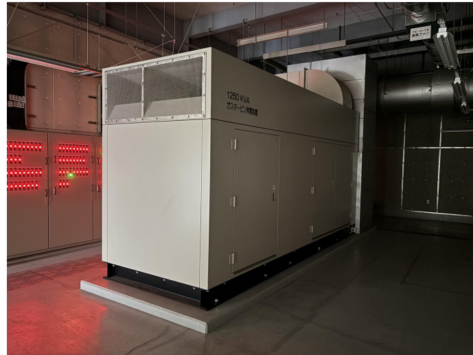
【写真：非常用電源（ガスタービン）】
